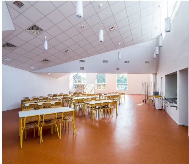
Groupe scolaire Marie Navart, Templeuve-en-Pévèle Centrales de traitement d'air GOLD, système climatique à la demande WISE et thermostats DETECT
