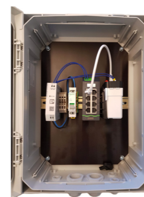
Figur 6. INSIDE Connect i elskåp med strömbrytare och switch.
